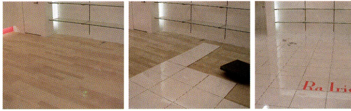
既設床面の上に仮止めテープを貼って設置して行きます。
